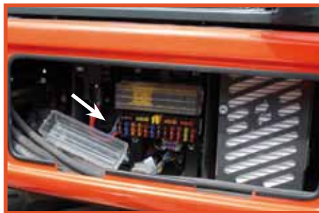
Isolierter Sicherungskasten und Computer- Diagnose- Anschluss.
