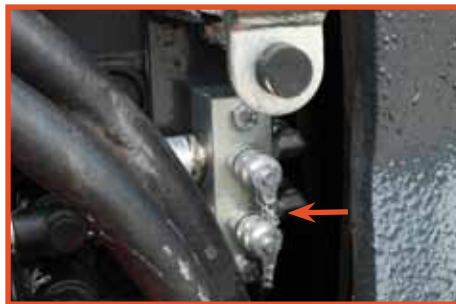
Schnellanschlüsse zum Ablesen der Pumpendrucke.
